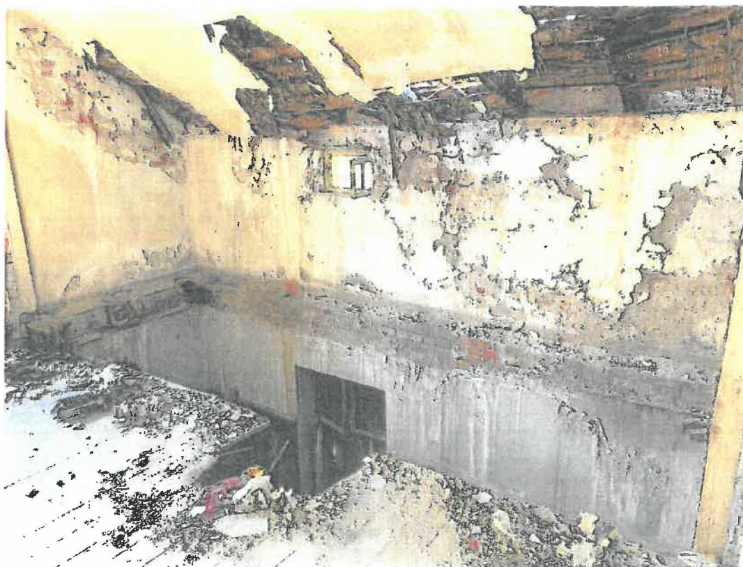
Foto 2: Ten istý priestor pod strechou, kde chýba časť stropu a nad ním aj stredová väznica. Krokvy sú nahnuté a značne prehnuté.
